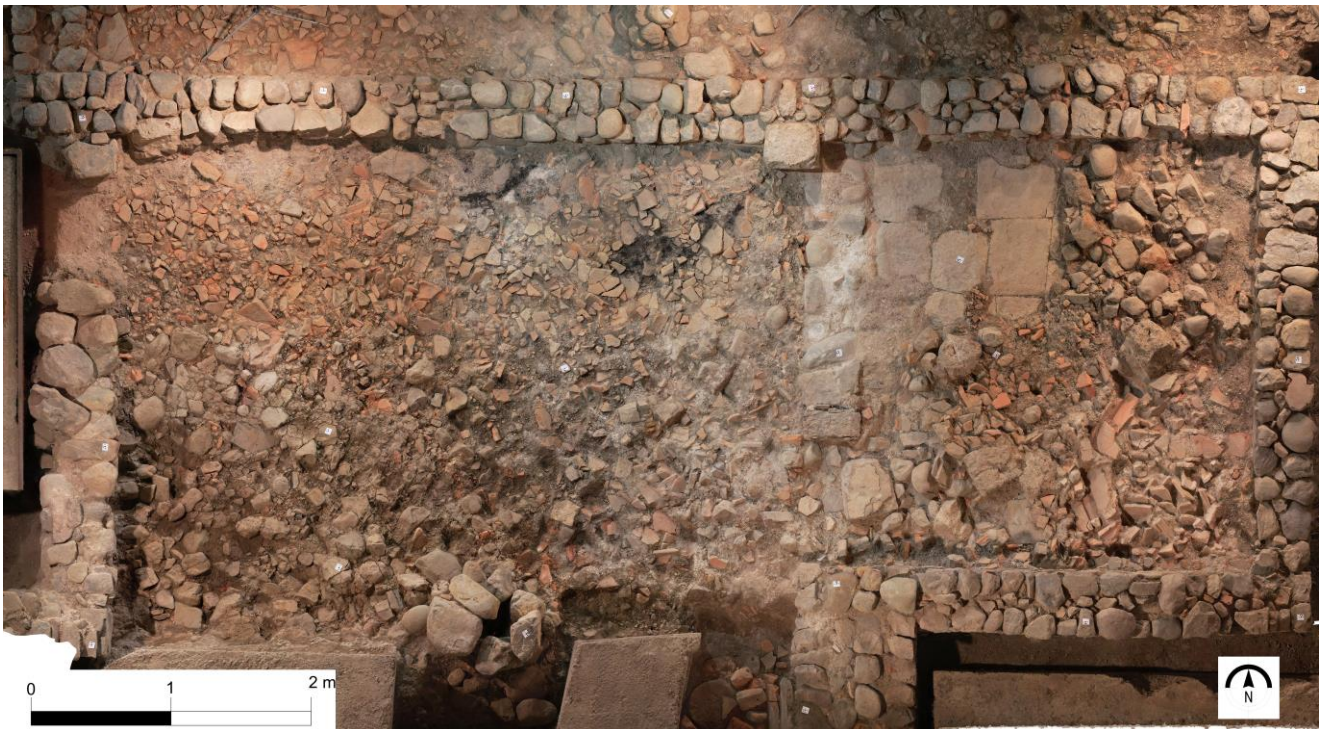
Fig. 14. Vano P1 e P2, crollo del tetto in laterizi e coppi nel vano P1 e P2 (orto foto elaborata da A. Massari).
