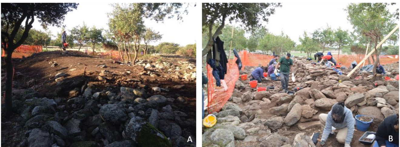
Fig. 8. Santa Vittoria di Serri. Rimozione degli strati superficiali e messa in evidenza del muro (foto G. Paglietti).
