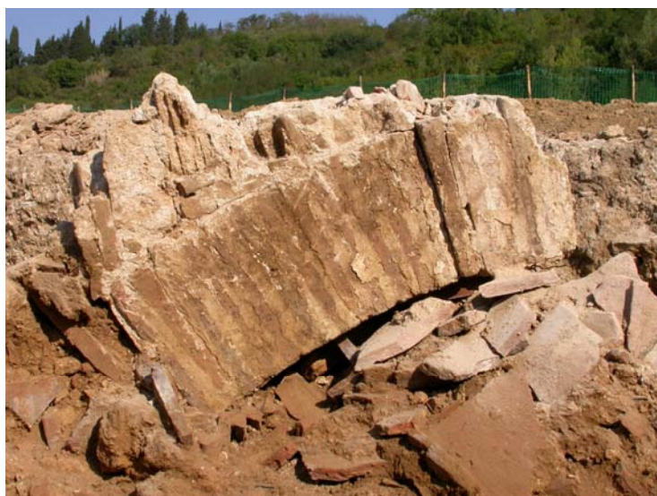
Fig. 25. Foto del crollo dell’arco laterizio che sosteneva la copertura dell’abside NO.
