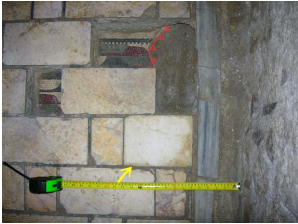
Fig. 26. Domus, III fase, vano A, margine Nord del piano 86, restauro con formella di recupero, in marmo, di modulo leggermente maggiore rispetto alle originarie, posta in sostituzione di una in palombino. Nei vuoti del piano si osserva la sovrapposizione con il piano di I fase tagliato dalla fondazione del muro di II fase.
