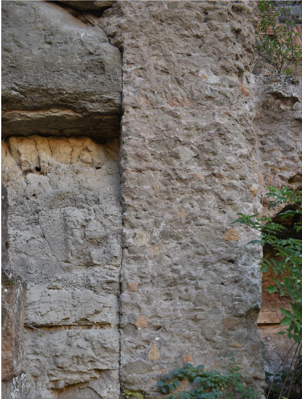
Fig. 8. Muro 6, particolare del nucleo.
