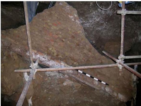
Fig. 3. Via Ariosto - Ex scuola media "Silvio Pellico". Crollo della volta (US 213).
