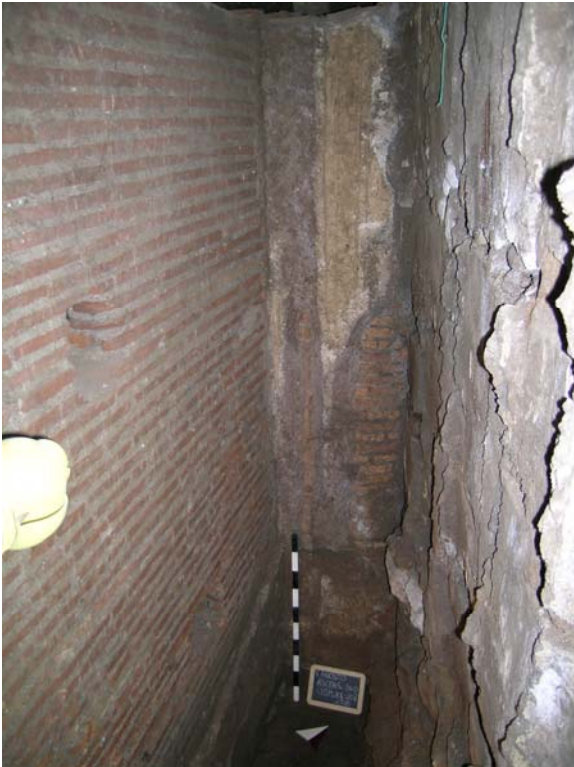
Fig. 6. Via Ariosto - Ex scuola media "Silvio Pellico". Ascensore sud.
