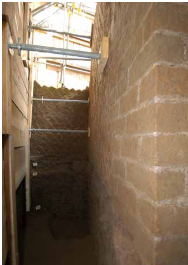
Fig. 4. Piazza Vittorio Emanuele II. Particolare dello spiccatto di una struttura muraria affacciata verso ovest (foto M. Letizia).
